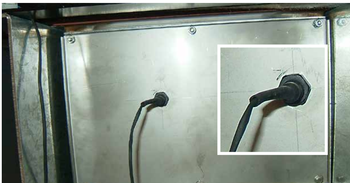
A kondenzvíz szintérzékelő helyzete
